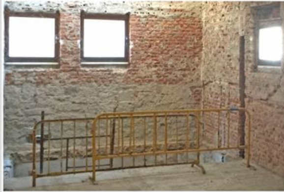
5015 y 1001 Las cocinas originales son ahora un local yermo con el forjado abierto hacia la planta de sótano
